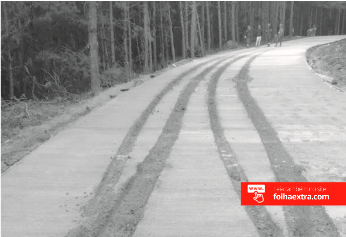
Circulação de veículos em trechos ainda não liberados provocou danos ao pavimento rígido de concreto
