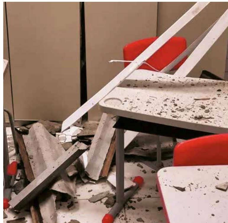
Em Ibaiti, uma escola municipal foi destelhada com a força dos ventos e aulas remanejadas
