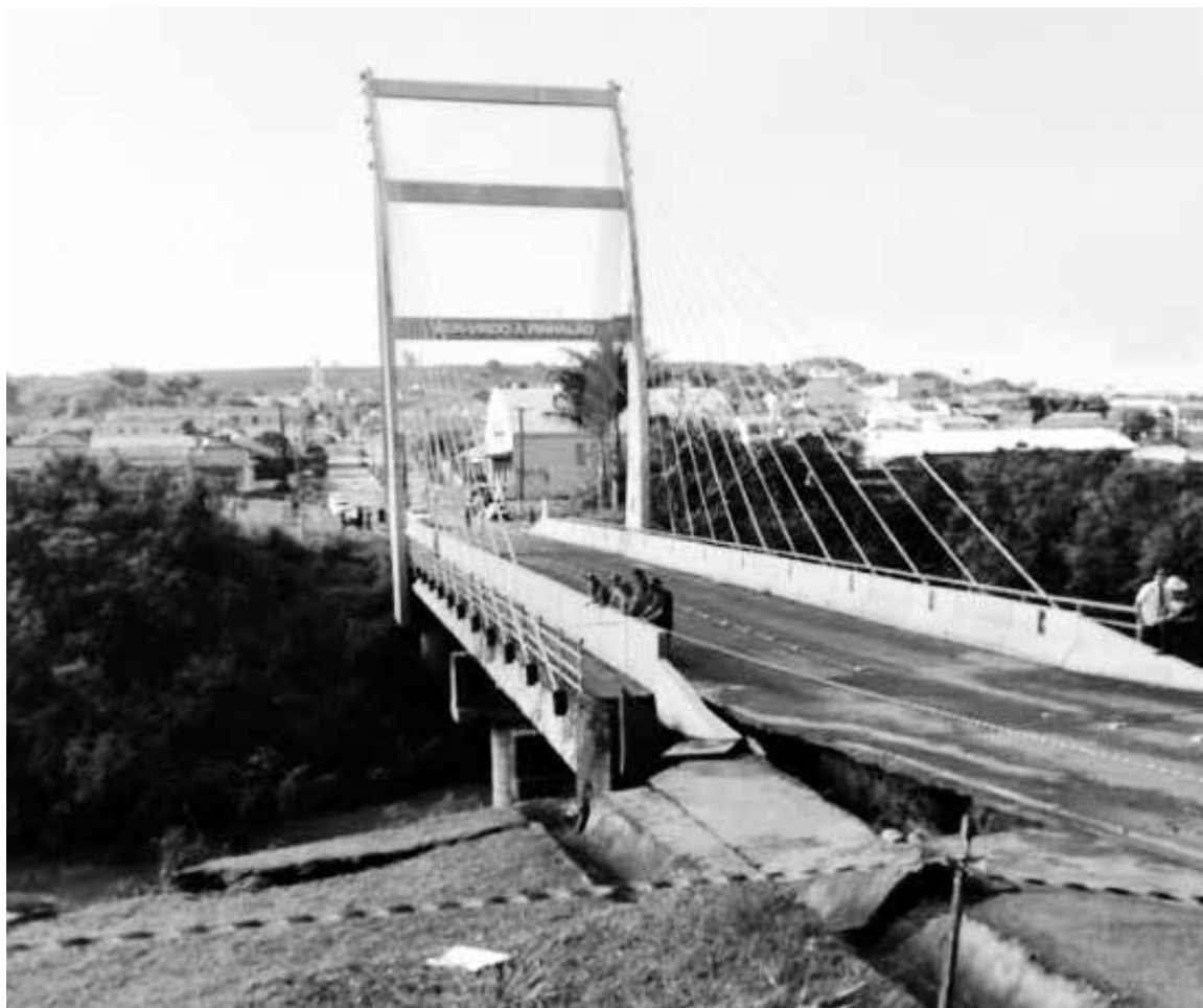
Ponte Estaiada Arzemiro Alves Izidoro após deslizamento de terra
